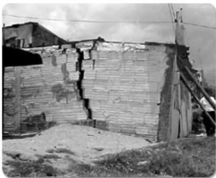
Vivienda afectada por la remoción en masa, objeto de reasentamiento.
